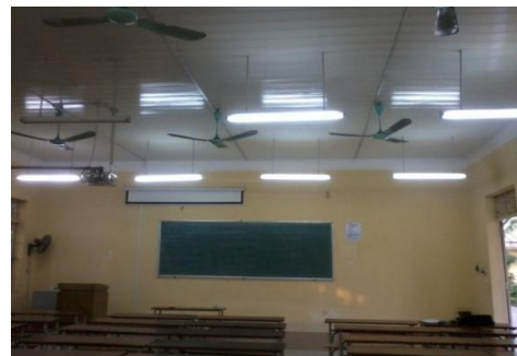
(d) Hệ thống đèn giảng đường CD106
