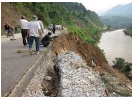
Hình 3. Sạt ở đất trên đường 8A
